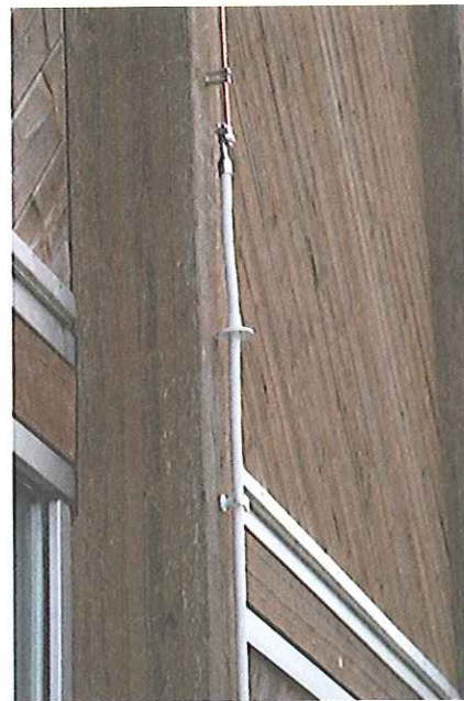
Obr.11.2.18 CUI vodič použitý na zabezpečenie izolácie zvodu pri dotyku
