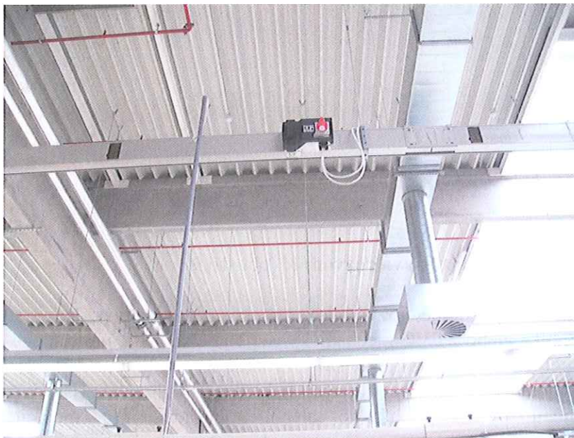
Obr. 16.7 Krytý prípojnicový rozvod
