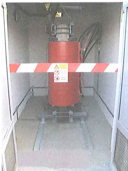
Obr. 8.20 Drevená prekážka s výstražnými značkami umiestnená na vstupe do stanovišťa transformátora VN/NN po otvorení vstupných dverí
