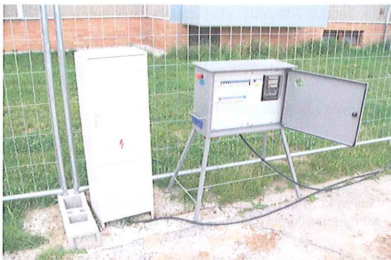
Obr.18.4.1 pevne umiestnený hlavný rozvádzač(vľavo) a prenosný podružný staveniskový rozvádzač(vpravo) na stavenisku
