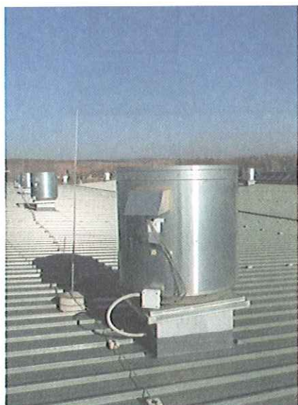
Obr. 11.4.4 tyčový zachytávač na streche zabráni zásahu blesku do jednotky vzduchotechniky
