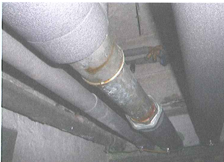
Obr. 10.9 Poškodené vodovodné potrubie následkom bludných prúdov pri nesprávnom pospájaní v objekte budovy
