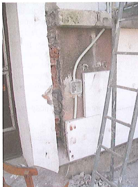
Obr.11.2.15 Nesprávne uloženie zvodu bleskozvodu pri zatepľovaní objektu. Zvod sa nachádza v trieštivej rúrke, ktorá nie je mechanicky prichytená k vonkajšej stene
