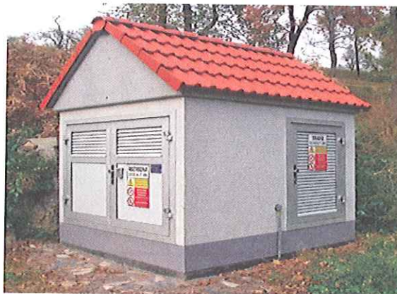
Obr.23.9 Kiosková transformačná stanica
