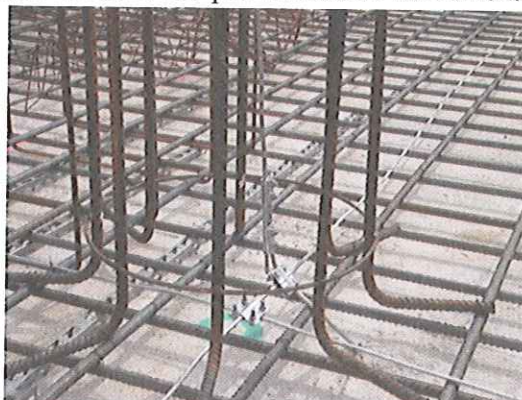
Obr.10.3 Základový uzemňovač prechádzajúci do betónového monolitu stavby
