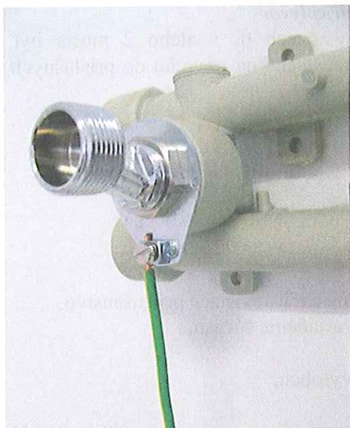
Obr. 18.1.6 Pripojenie vaňovej batérie na doplnkové ochranné pospájanie prostredníctvom svorky ZS4 navlečenej na vonkajší závit vodovodnej batérie a pritiahnuté maticou na vonkajšiu spojku potrubia pred vykachličkovaním
