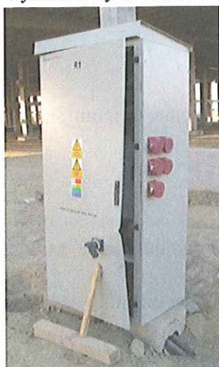
Obr.9 Zníženie krytia následkom poškodenia dverí rozvádzača
